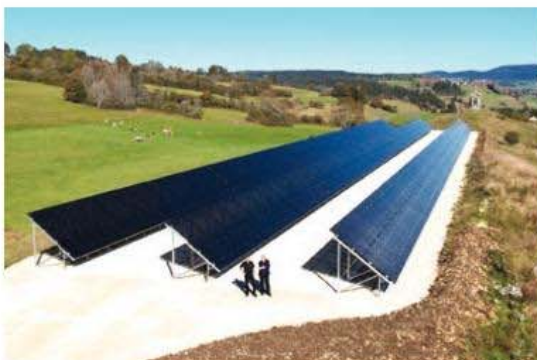
Depuis 2018 à Rochejean, des panneaux solaires alimentent la commune en électricité dans sa quasi globalité. Crédit Photo : SIEL
