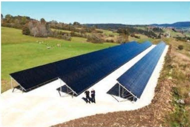
Depuis 2018 à Rochejean, des panneaux solaires alimentent la commune en électricité dans sa quasi globalité. Crédit Photo : SIEL
